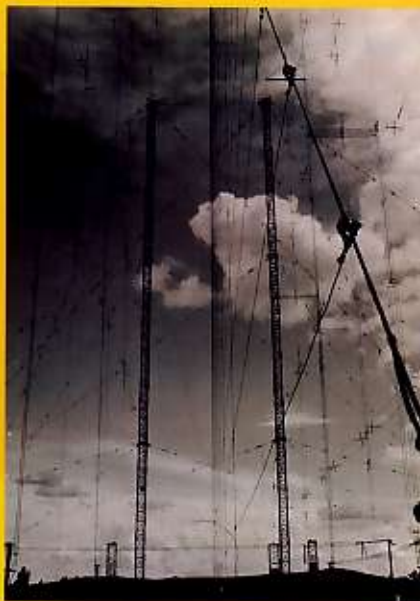
Het antennepark van relaisstation Rwanda.
